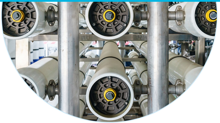
Filtración con ósmosis inversa.
